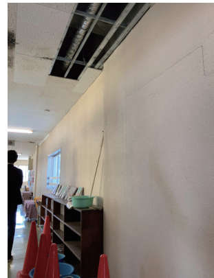
雨漏りで天井に穴(本町小)
